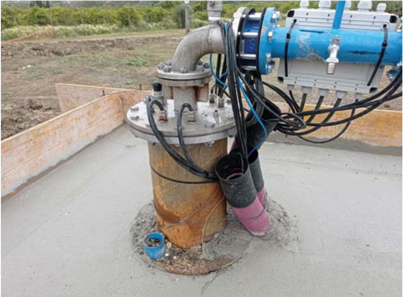
Figura 7.7.4. Cierre estanco con placa de anclaje unida a la tubería de emboquille del sondeo con brida y tornillería. Elevación de seguridad de 60 cm sobre la cota del suelo. Fuente: AQUATEC.
