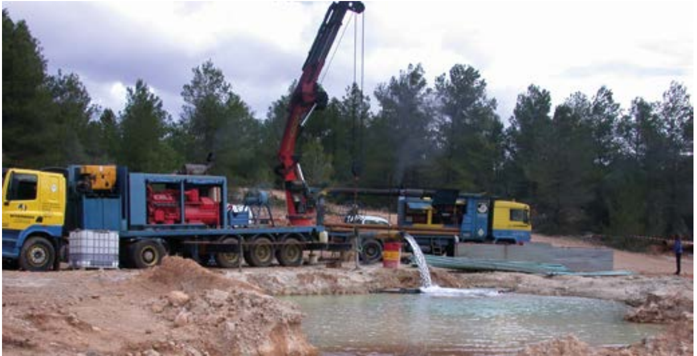
Ensayo de bombeo previo a la desinfección de un pozo. Autor: José Antonio Domínguez.
