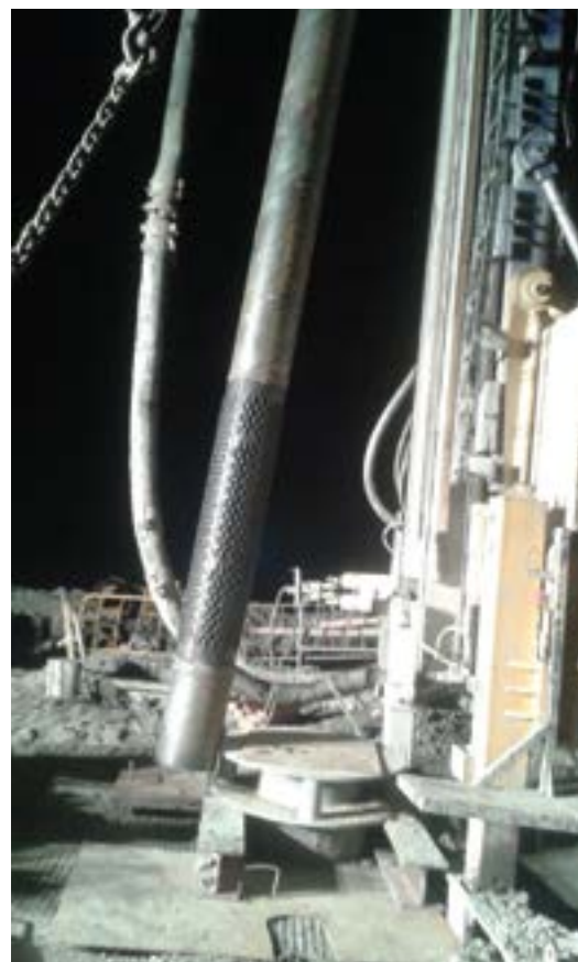
Detalle del final de la entubación de un sondeo con filtro puentecillo. Autor: Juan Franqueza.
