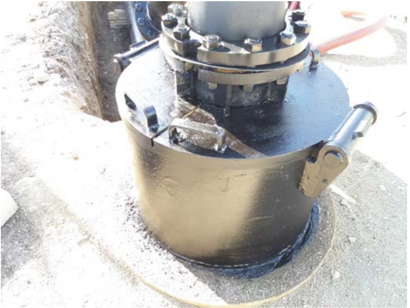
Figura 7.7.3. Cierre con abarcón tipo charnela elevado 60 cm sobre la cota del suelo. Fuente: AQUATEC.
