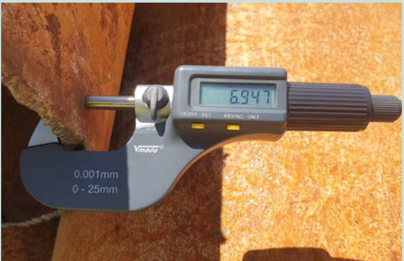
Comprobación del espesor de una tubería de revestimiento. Autor Juan Antonio Hernández Bravo.
