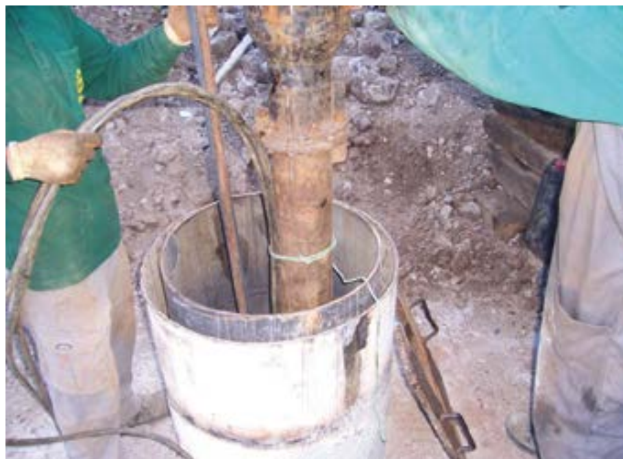
Detalle de la instalación de un tubo guía metálico, para la introducción de un hidronivel, y de un tubo guía de PVC, para la instalación de un sensor de presión automático. Autor: Sergio Martos-Rosillo.
