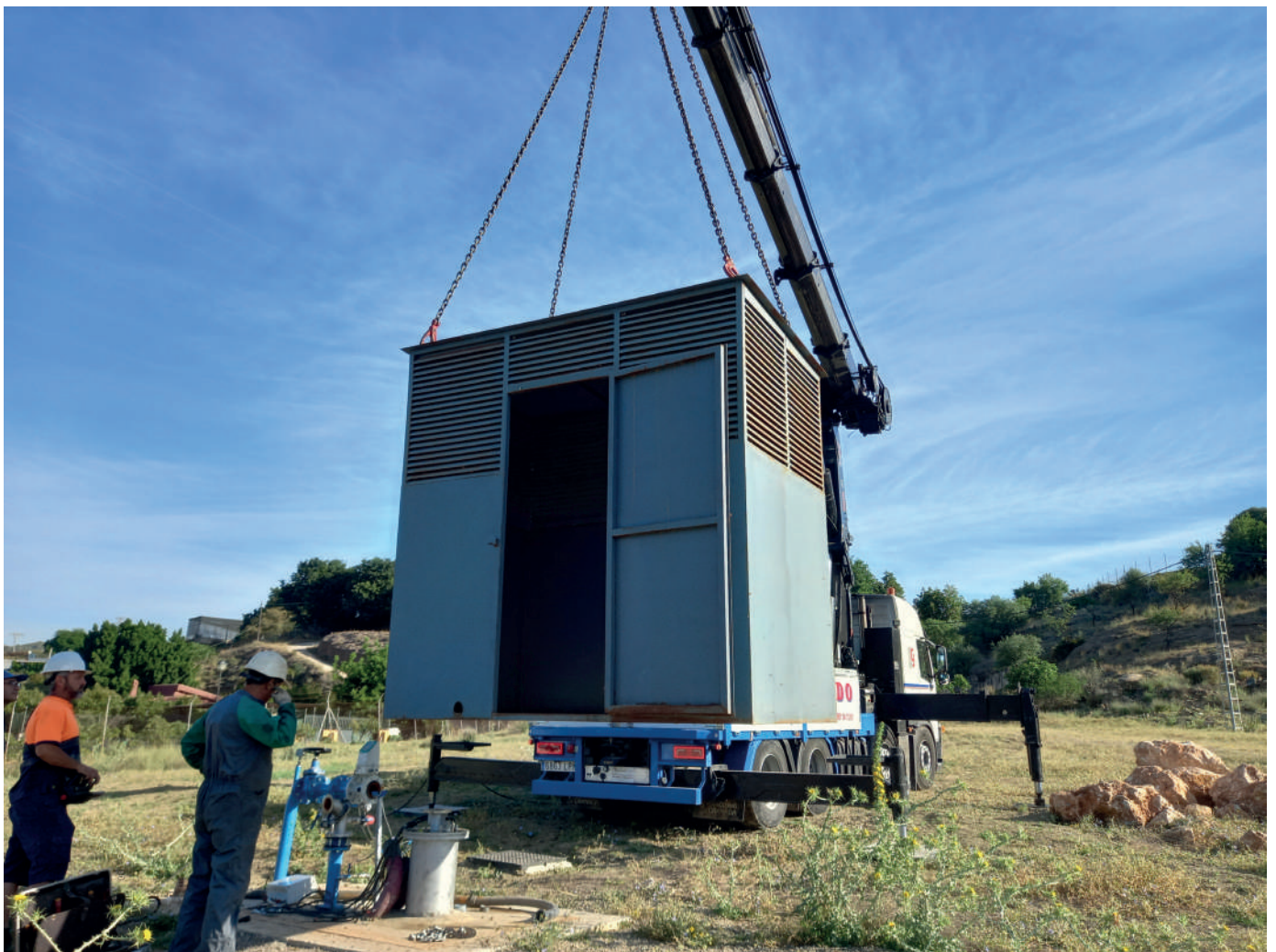
Figura 7.7.6. Caseta metálica móvil para la protección de la cabeza del pozo. Fuente: AQUATEC.
