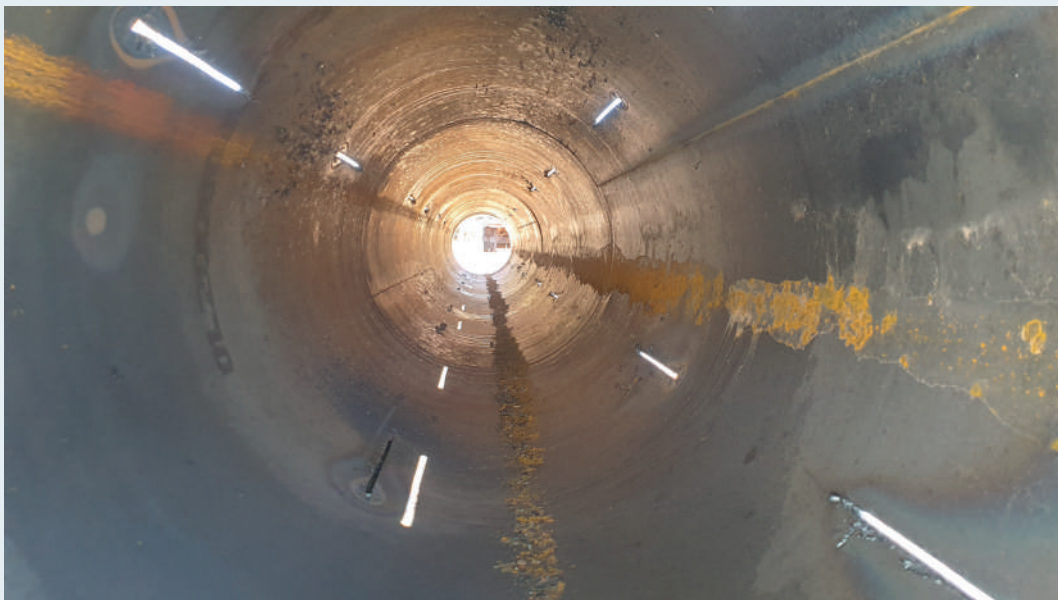
Vista interior de una tubería ranurada.
