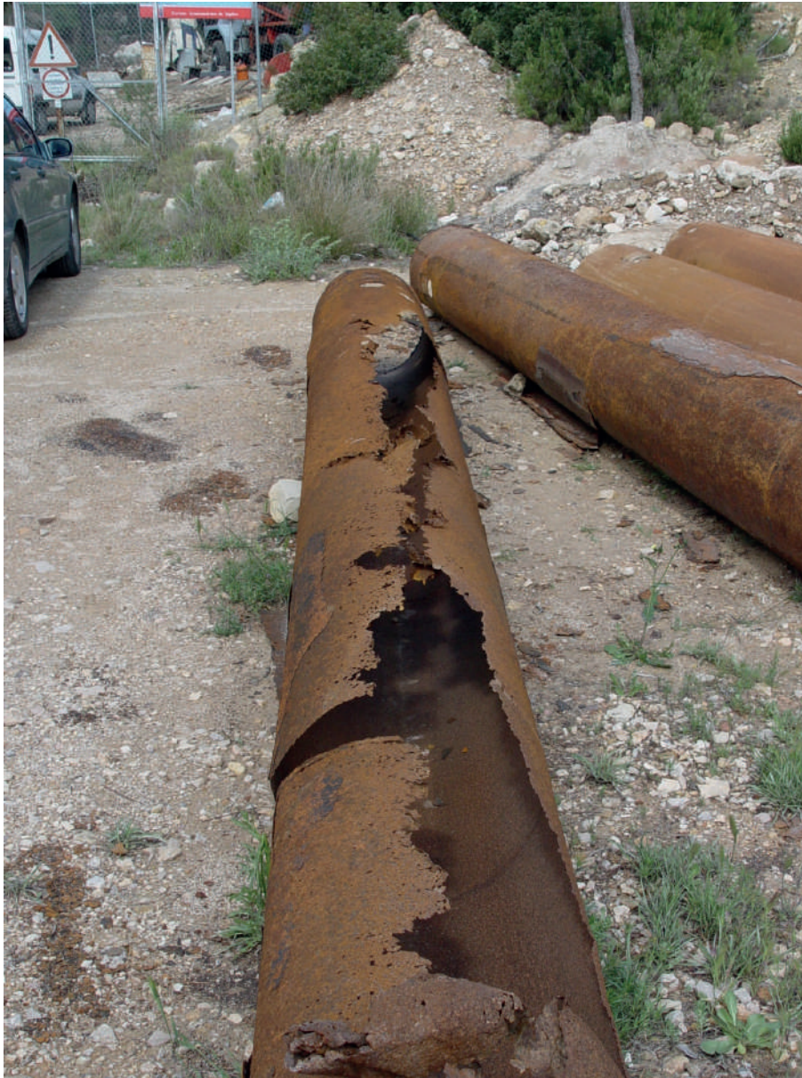
Figura 7.3.1. Detalle del estado de un tubo de acero normal corroído a los pocos años de su instalación en un acuífero con agua salada.
