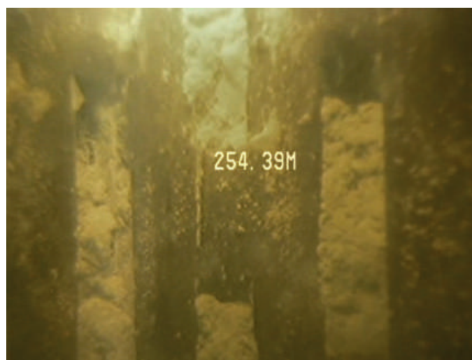
Mismo tipo de filtro con insuficiente grado de limpieza . Se observan depósitos de lodo de perforación. Fuente: AQUATEC.
