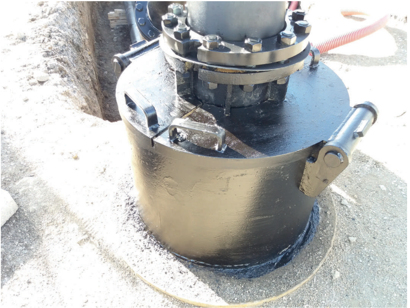
Figura 7.7.3. Cierre con abarcón tipo charnela elevado 60 cm sobre la cota del suelo. Fuente: AQUATEC.
