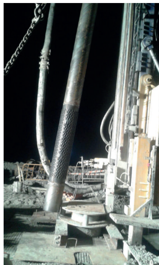
Detalle del final de la entubación de un sondeo con filtro puentecillo. Autor: Juan Franqueza.
