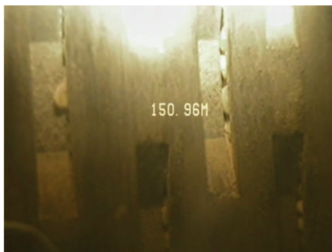
Tramo de filtro tipo puentecillo con un correcto estado de limpieza y desarrollo , se observa incluso el detalle de la grava del filtro a través de los puentes. Fuente: AQUATEC.
