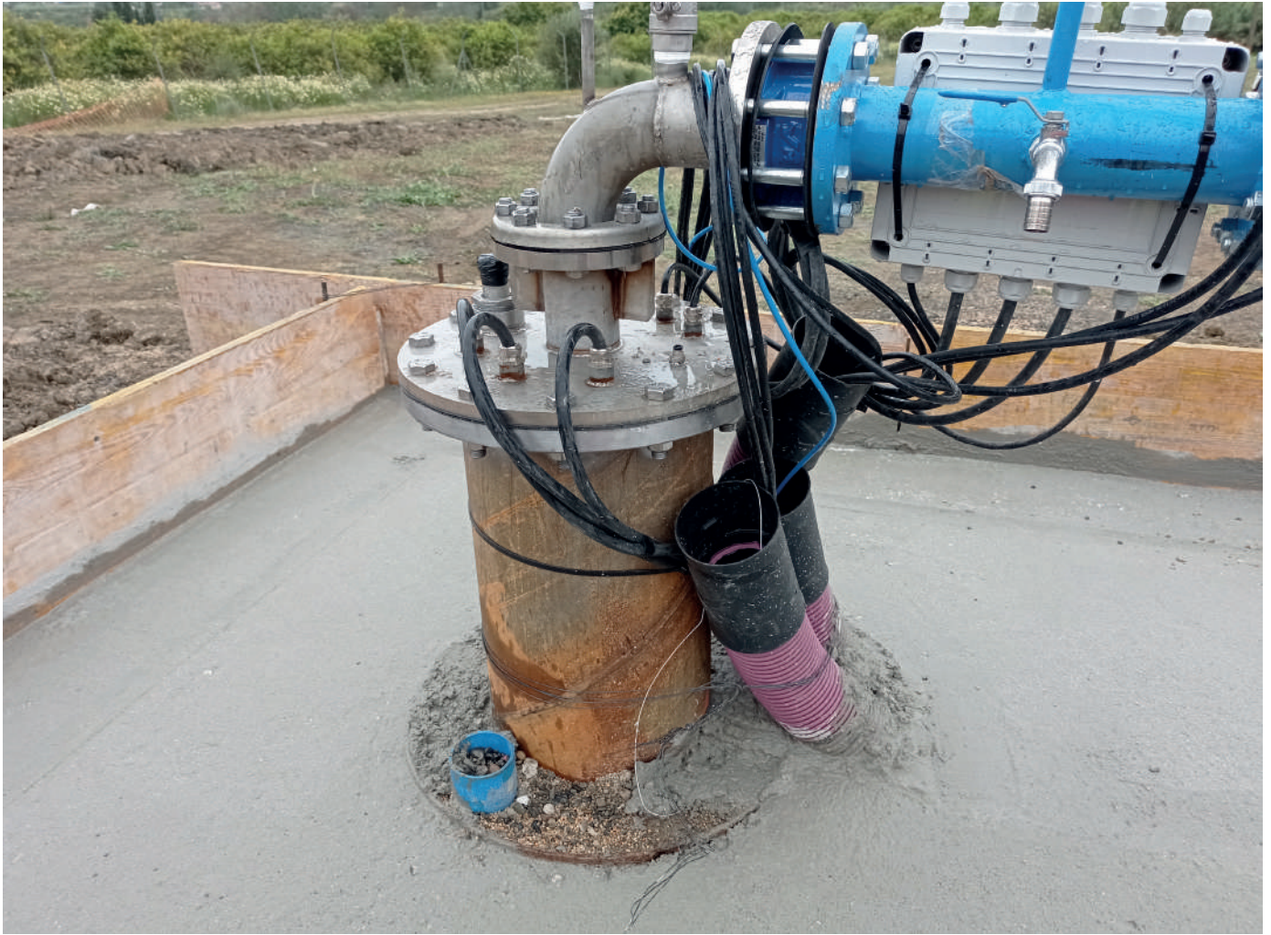
Figura 7.7.4. Cierre estanco con placa de anclaje unida a la tubería de emboquille del sondeo con brida y tornillería. Elevación de seguridad de 60 cm sobre la cota del suelo. Fuente: AQUATEC.
