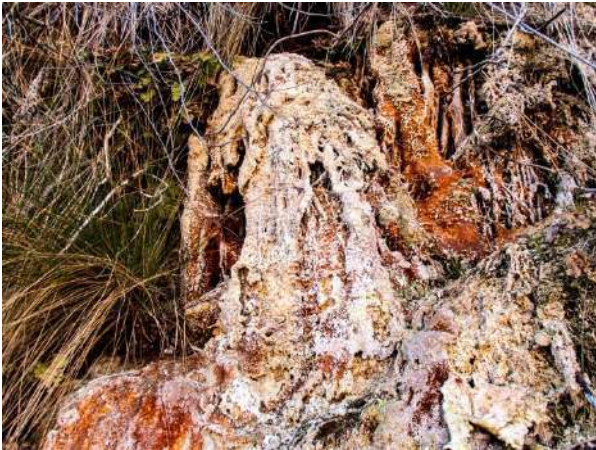
Figura 4. Precipitación de carbonato cálcico en las paredes del acueducto del Toril fosilizando las plantas que las recubren.
