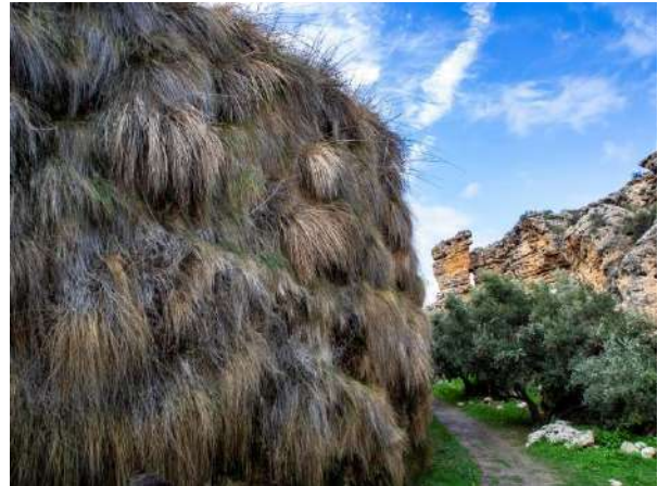
Figura 14. Crecimiento de comunidades vegetales en las paredes del Acueducto del Toril.
