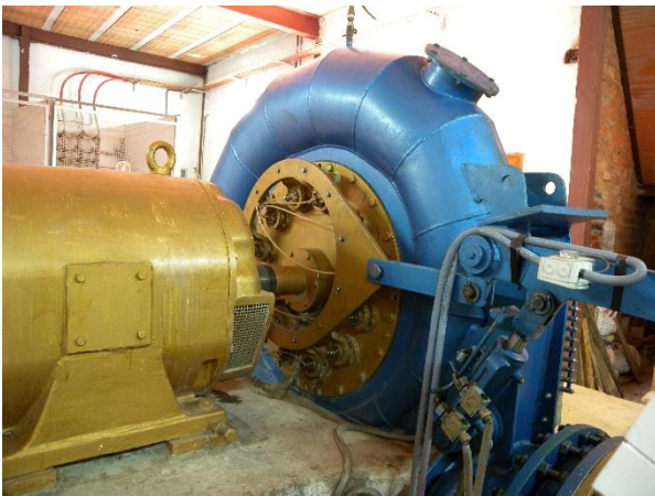
Maquinaria de la minicentral de Villel
