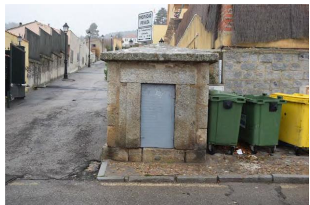
Figura 17. Estado de la arquilla de la C/ Cebadillas, 5 antes de su restauración
