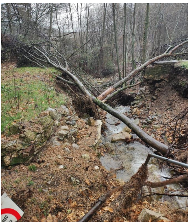
Figura 30. Destrozos causados por la DANA de 2023
