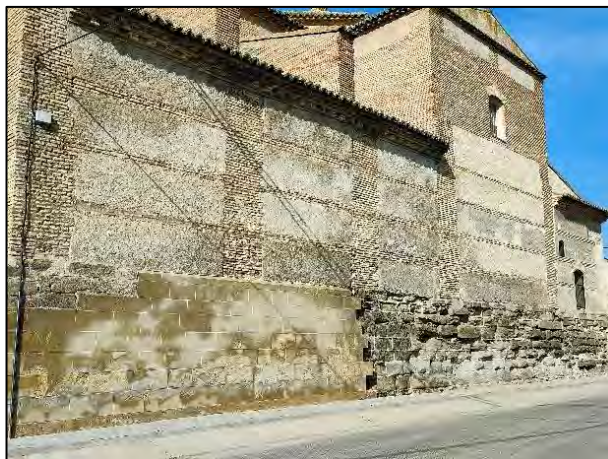
Figura 24. Aspecto actual tras las obras de rehabilitación, donde se observa la continuidad del efecto producido por la salinidad del agua capilar.
