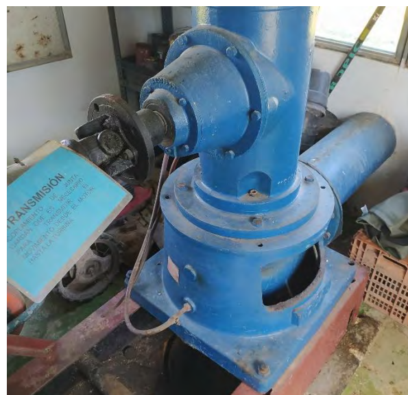
Foto 13: Equipo de bombeo del pozo Ullal de Quartons..
