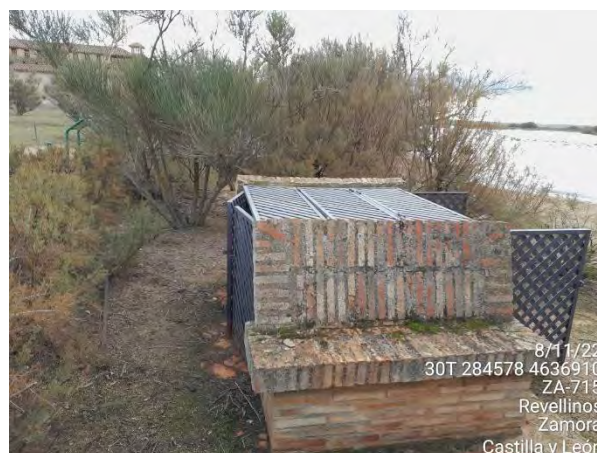
Figura 10: Caseta de protección del sondeo de la Casa del Parque.
